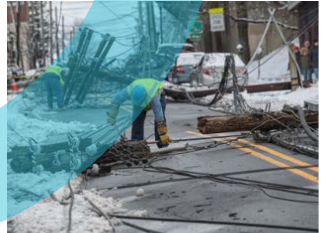
Source: Con Edison
